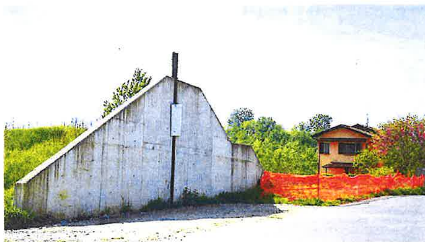
I lavori di consolidamento dell'argine del Po alla frazione Santa Margherita sono iniziati dieci anni fa
